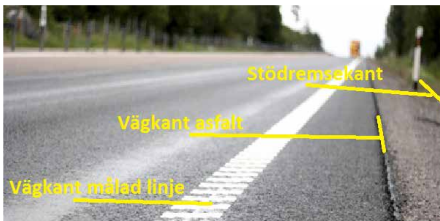
Figur 1 Väggkant, målad linje och stödremsekant asfalt
