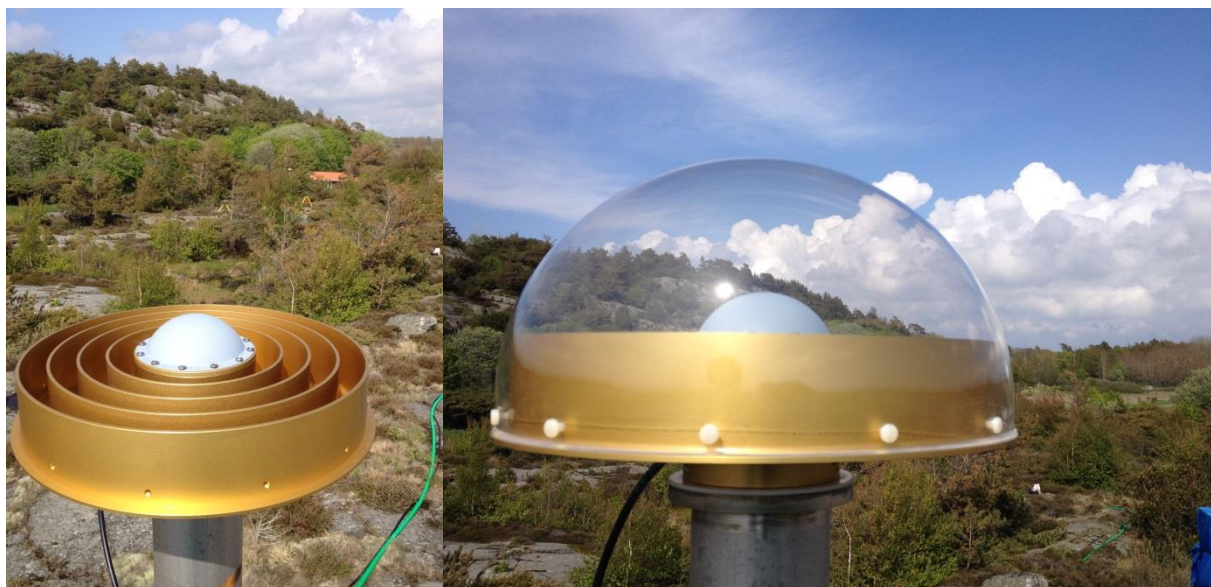
Den dubbelkalibrerade Javadringant-DM utan radom innan ändringen (vänster) och samma antenn med en OSOS-radom efter ändringen (höger).
