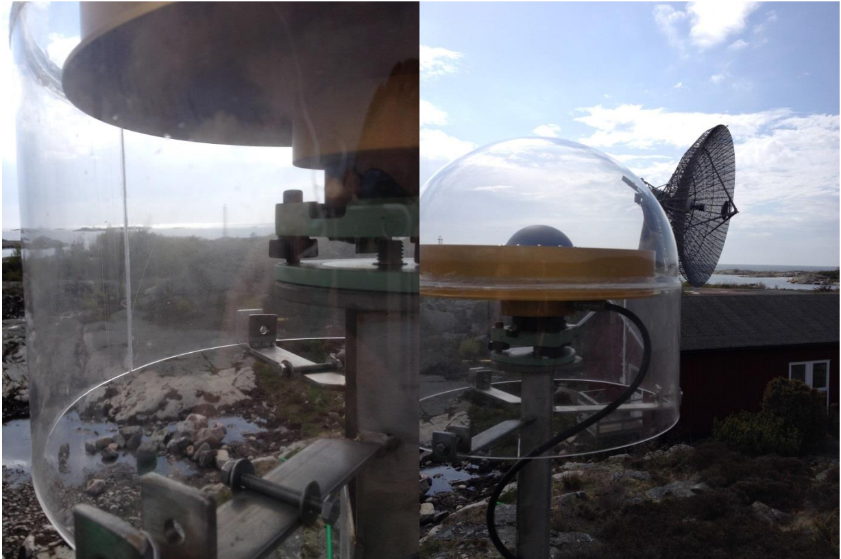
OTT4-masten innan ändringen (vänster) och OTT4-masten efter att OSOD-radomen har lossats, vridits ett tredjedels varv i klockans riktning och därefter satts fast (höger).
