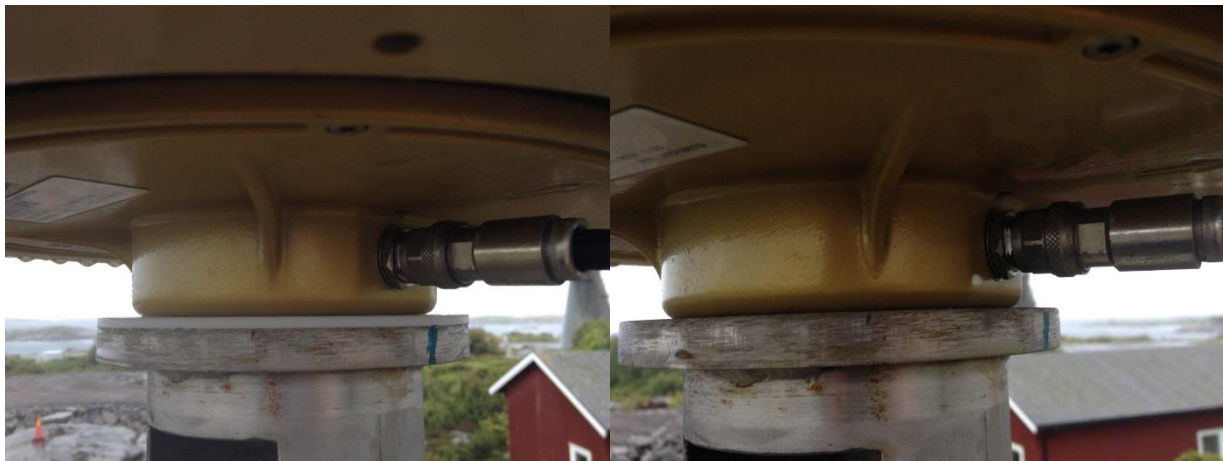
Toppen av OTT4-masten med isolerande skikt mellan antenn och antennfot innan ändringen (vänster) och utan isolerande skikt (höger).
