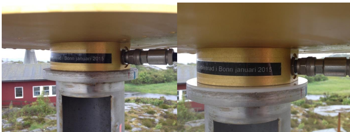
Toppen av OTT2-masten utan isolerande skikt mellan antenn och antennfot innan ändringen (vänster) och med isolerande skikt (höger).
