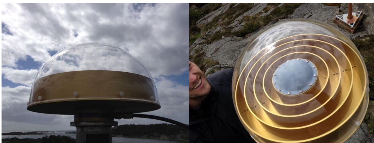
Antennen (Javadrिंगant-DM) på OTT2-masten med OSOS-radom innan ändring (vänster och höger).
