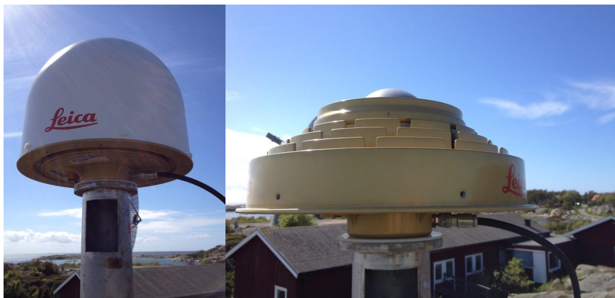
Antennen LEIAR25.R3 installerad på OTT4-masten med LEIT-radom innan ändringen (vänster) och samma antenn utan radom efter ändringen (höger).
