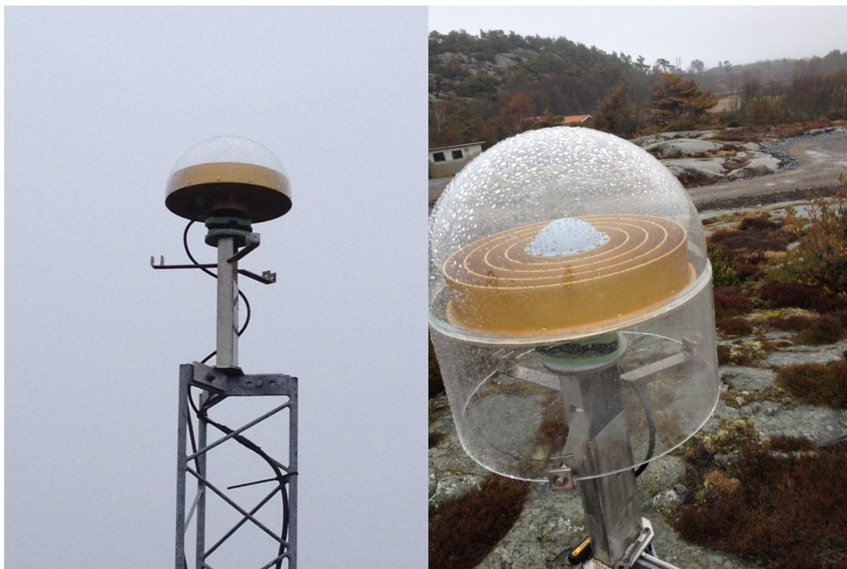
OTT4-masten innan ändringen då antennen har en OSOS-radom (vänster) och OTT4-masten efter ändringen då antennen har en OSOD-radom som sitter fast i antennfotens 3 armar (höger).
