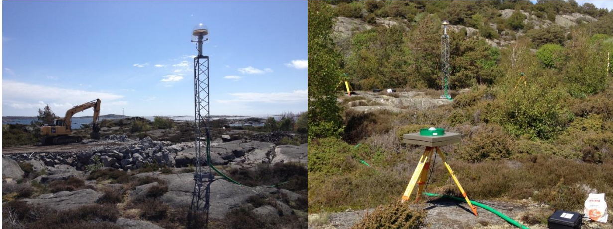
Arbetet med vägen söder om OTT4, mellan OTT4 och OTT6, som påbörjades under tisdag (vänster) och stationskalibreringsstationer med olika mycket eccosorb runt OTT1 (höger).
